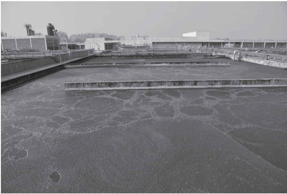
Veduta del depuratore di San Rocco a Ronchetto delle Rane dove si possono fare visite guidate gratuite. Fotografia di Maurizio Ghidoli
